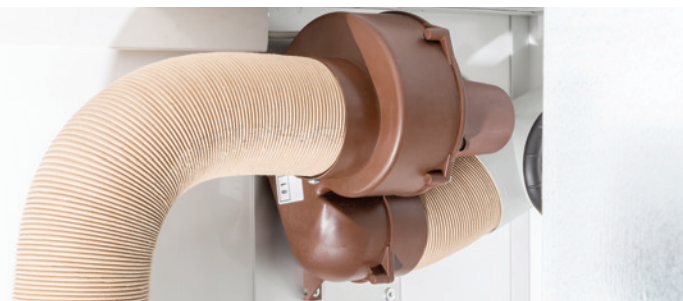
Kanavapuhallin puhalttaa lämpimän ilman kaikkiin tiloihin.
